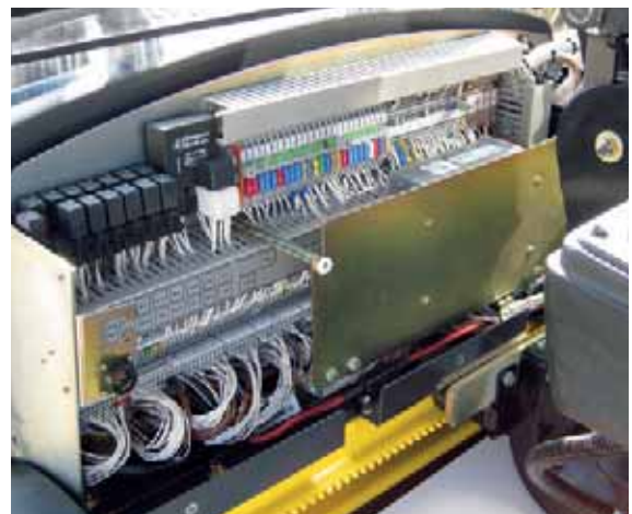
Central de distribución: el sistema electrónico detrás del asiento del conductor.
